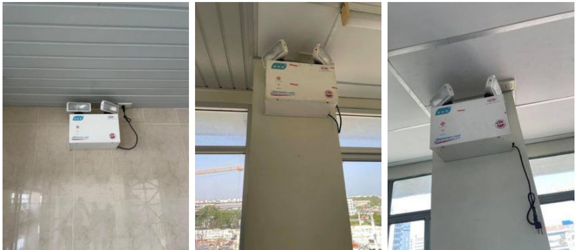
ภาพที่ 13 ภาพไฟฉุกเฉินชั้น 9
