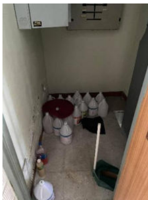
ภาพที่ 37 ภาพห้องควบคุมไฟฟ้า ชั้น 8
