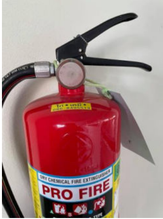
ภาพที่ 21 ภาพถัดดับเพลิงชั้น 4
