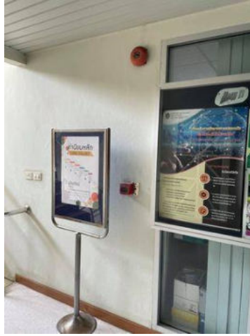
ภาพที่ 29 ภาพระบบแจ้งเหตุเพลิงไหม้ด้วยมือชั้น 2
