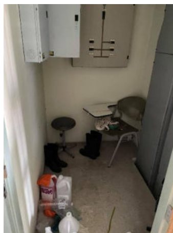
ภาพที่ 33 ภาพห้องควบคุมไฟฟ้า ชั้น 4
