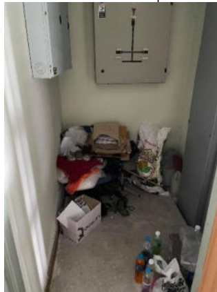
ภาพที่ 32 ภาพห้องควบคุมไฟฟ้า ชั้น 3
