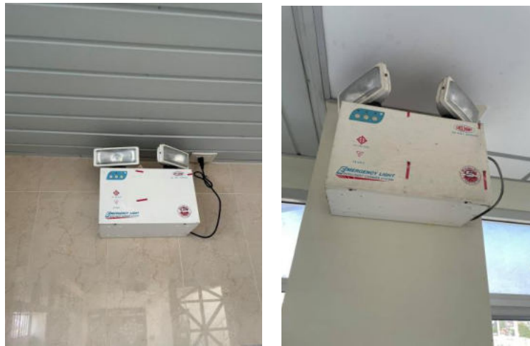
ภาพที่ 10 ภาพไฟฉุกเฉินชั้น 6
