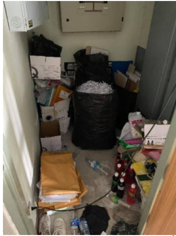
ภาพที่ 31 ภาพห้องควบคุมไฟฟ้า ชั้น 2
