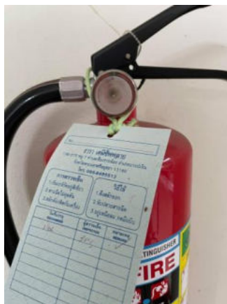
ภาพที่ 27 ภาพป้ายการตรวจสอบถังดับเพลิงชั้น 4
