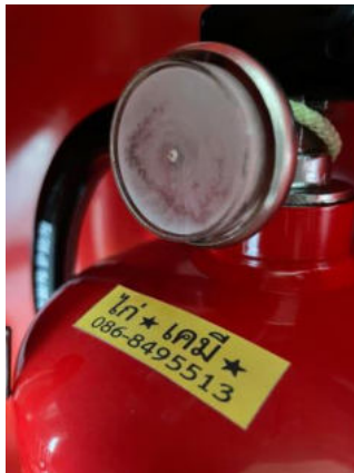
ภาพที่ 23 ภาพถัดดับเพลิงชั้น 8 ในตู้ดับเพลิง
