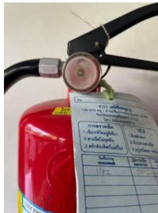
ภาพที่ 25 ภาพป้ายการตรวจสอบถังดับเพลิงชั้น 1
