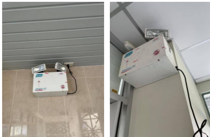
ภาพที่ 8 ภาพไฟฉุกเฉินชั้น 4
