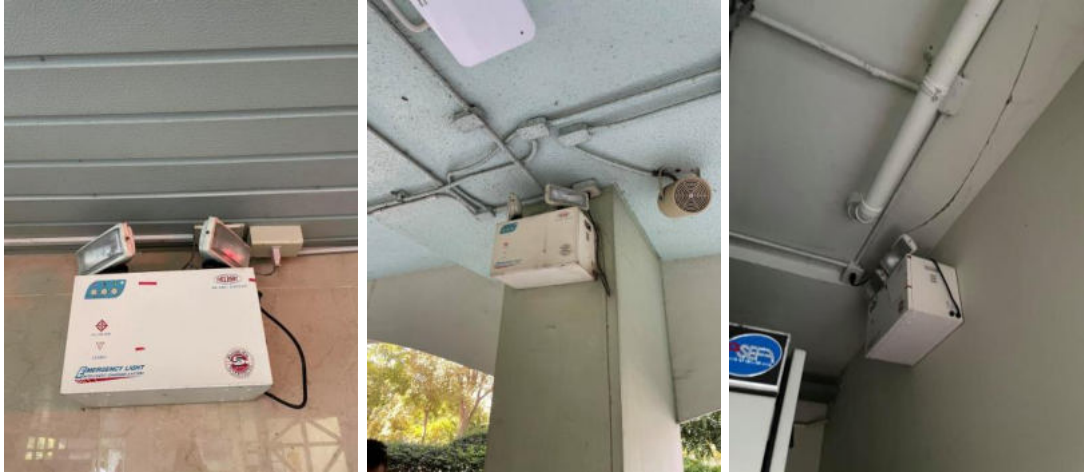
ภาพที่ 5 ภาพไฟฉุกเฉินชั้น 1
