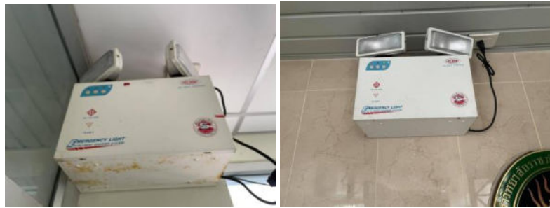
ภาพที่ 6 ภาพไฟฉุกเฉินชั้น 2
