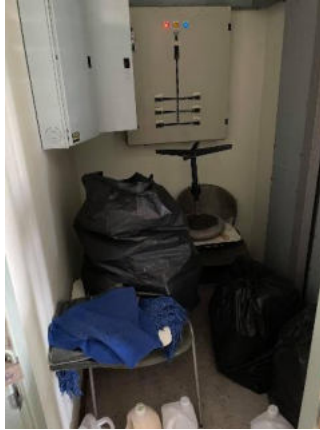
ภาพที่ 34 ภาพห้องควบคุมไฟฟ้า ชั้น 5
