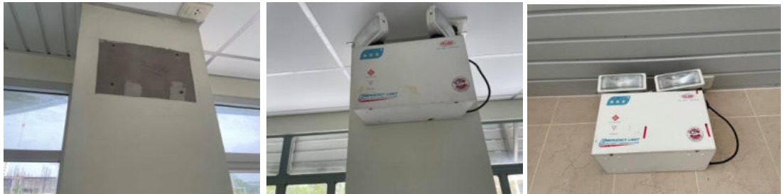
ภาพที่ 7 ภาพไฟฉุกเฉินชั้น 3
