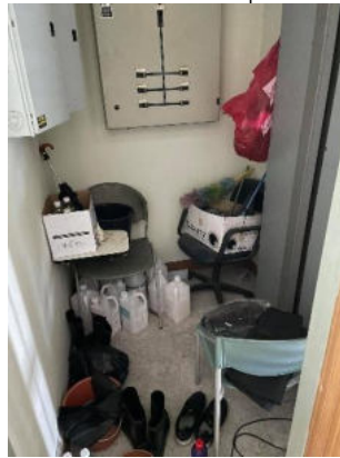
ภาพที่ 35 ภาพห้องควบคุมไฟฟ้า ชั้น 6
