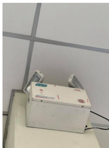
ภาพที่ 11 ภาพไฟฉุกเฉินชั้น 7
