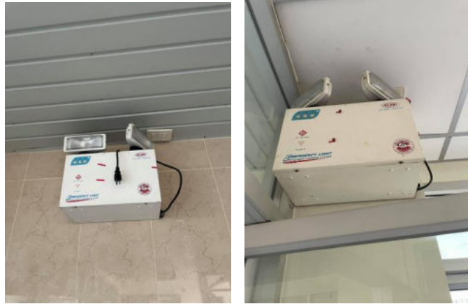
ภาพที่ 9 ภาพไฟฉุกเฉินชั้น 5
