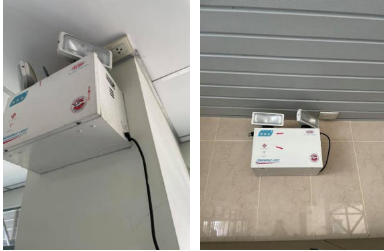
ภาพที่ 12 ภาพไฟฉุกเฉินชั้น 8
