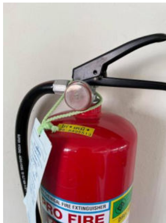
ภาพที่ 22 ภาพถัดดับเพลิงชั้น 6
